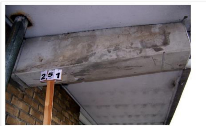
Console aan zowel onder- als bovenzijde gescheurd, reparatie dringend nodig. !! Let op is nr 351
