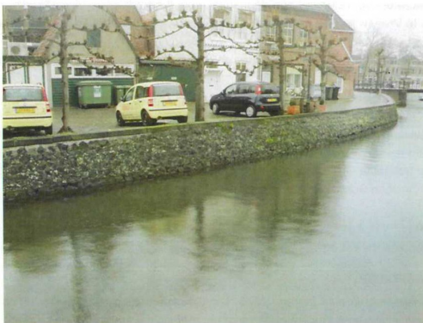
Foto 1: Kade voorhaven west, voegen op de waterlijn uitgevallen
